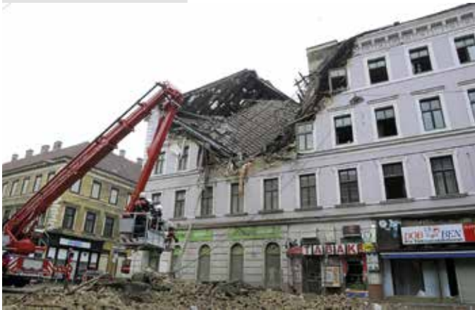
➤ Teilweiser Einsturz des Bauwerks in der Wiener Mariahilfer Straße (Foto: BF Wien).
