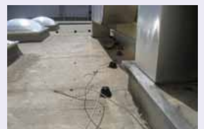
Wenn die Blitzschutzanlage Mängel aufweist, besteht in der Regel höhere Gefahr als ohne Blitzschutzanlage!
