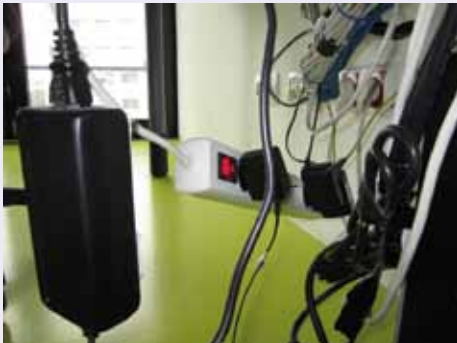
Eine der wichtigsten periodischen Prüfungen betrifft die Elektroanlage des Betriebes.
