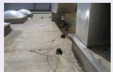
Wenn die Blitzschutzanlage Mängel aufweist, besteht in der Regel höhere Gefahr als ohne Blitzschutzanlage!
