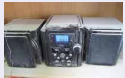
So genannte ortsveränderliche haushaltsübliche Elektrogeräte sind im Unternehmen hohen Beanspruchungen ausgesetzt und werden zur Brandgefahr.
