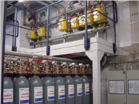
INERGEN-Anlage (Quelle: Tyco).
